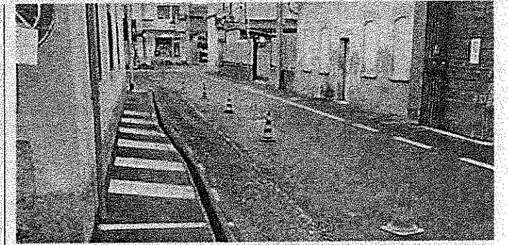
Via Diaz a Palazzolo: appena asfaltata, già rotta per posare la fibra
