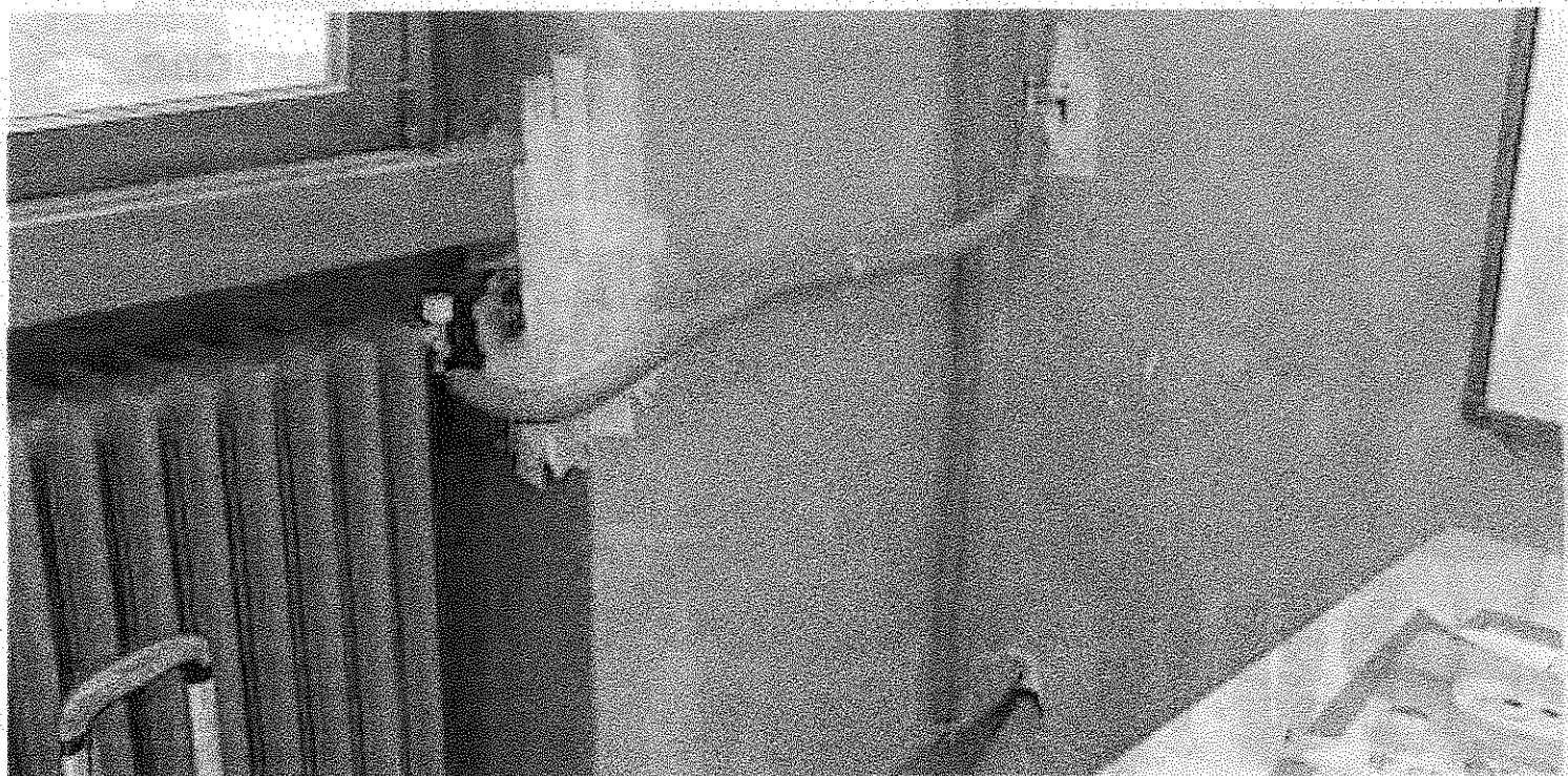
Le tubature a vista nell'istituto comprensivo scolastico di via IV Novembre Emilio de Marchi
