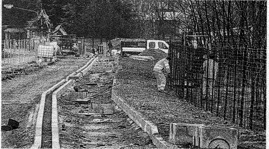
Approvati i progetti di rigenerazione urbana, connessione tra luoghi e riqualificazione ambientale
